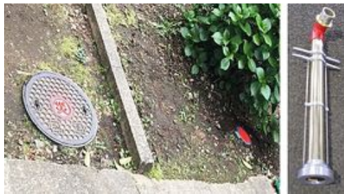
豊玉第二小学校に設置されている応急給水栓（左）、スタンドパイプ（右）
