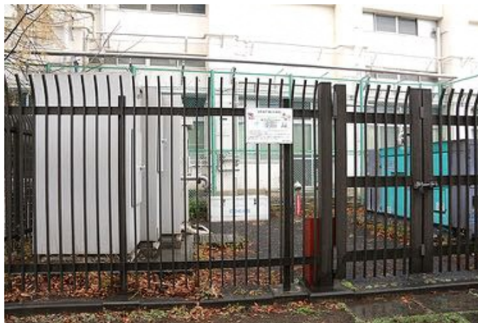
防災井戸（中新井公園）。水質検査を定期的を実施しており、停電時でも使用できるよう発電機が併設されています
