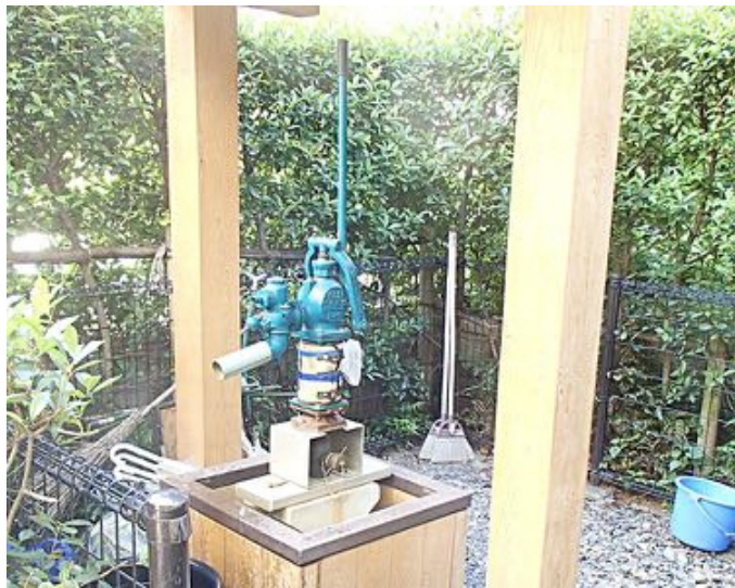
ミニ防災井戸（個人宅）。深さ8メートル程度の浅井戸で、停電時でも使用できるよう手動ポンプが設置されています
