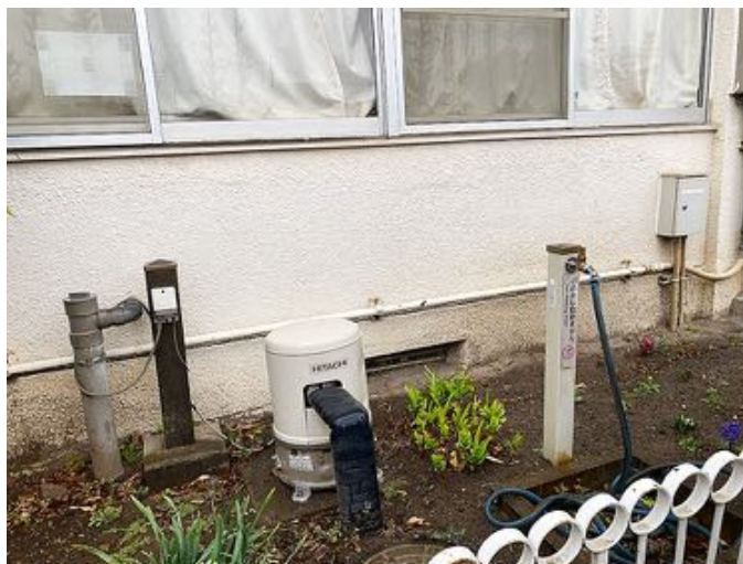
学校防災井戸（豊玉第二小学校）。深さ25メートル程度の浅井戸で、学校に設置されている発電機で電動ポンプを稼働させ、水を汲み上げます
