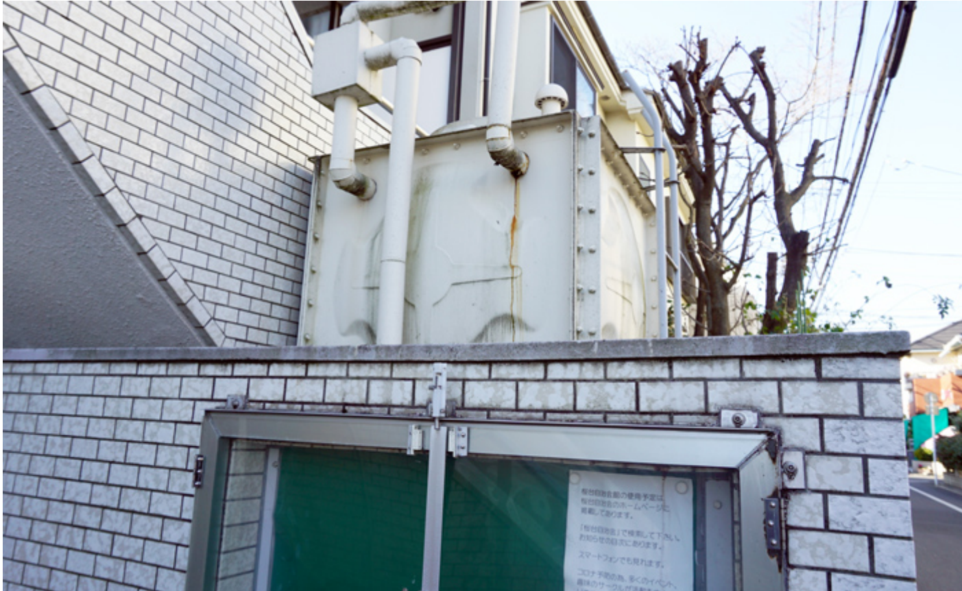
こちらのタンクの場所に、防災井戸が掘れないか計画中とのこと
