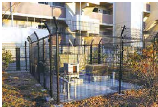
中村KASHIWA公园防灾水井
