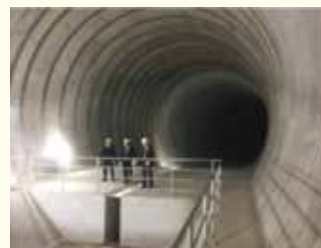
白子川地下调节池（容量：212,000m 3 ） 构造形式：地下隧道式 台风19号导致的储水率：约9成
